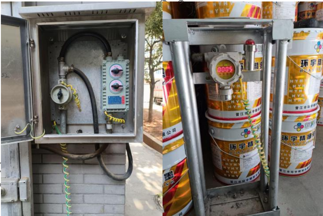
附图2 生产车间防爆操作柱和可燃气体报警器均已采取静电接地措施
