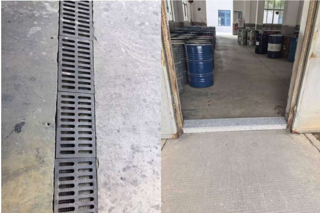
附图1 原料仓库二（甲类）防止液体流散的导流沟杂物已清理干净，出入口均已设置防止液体流散的设施
