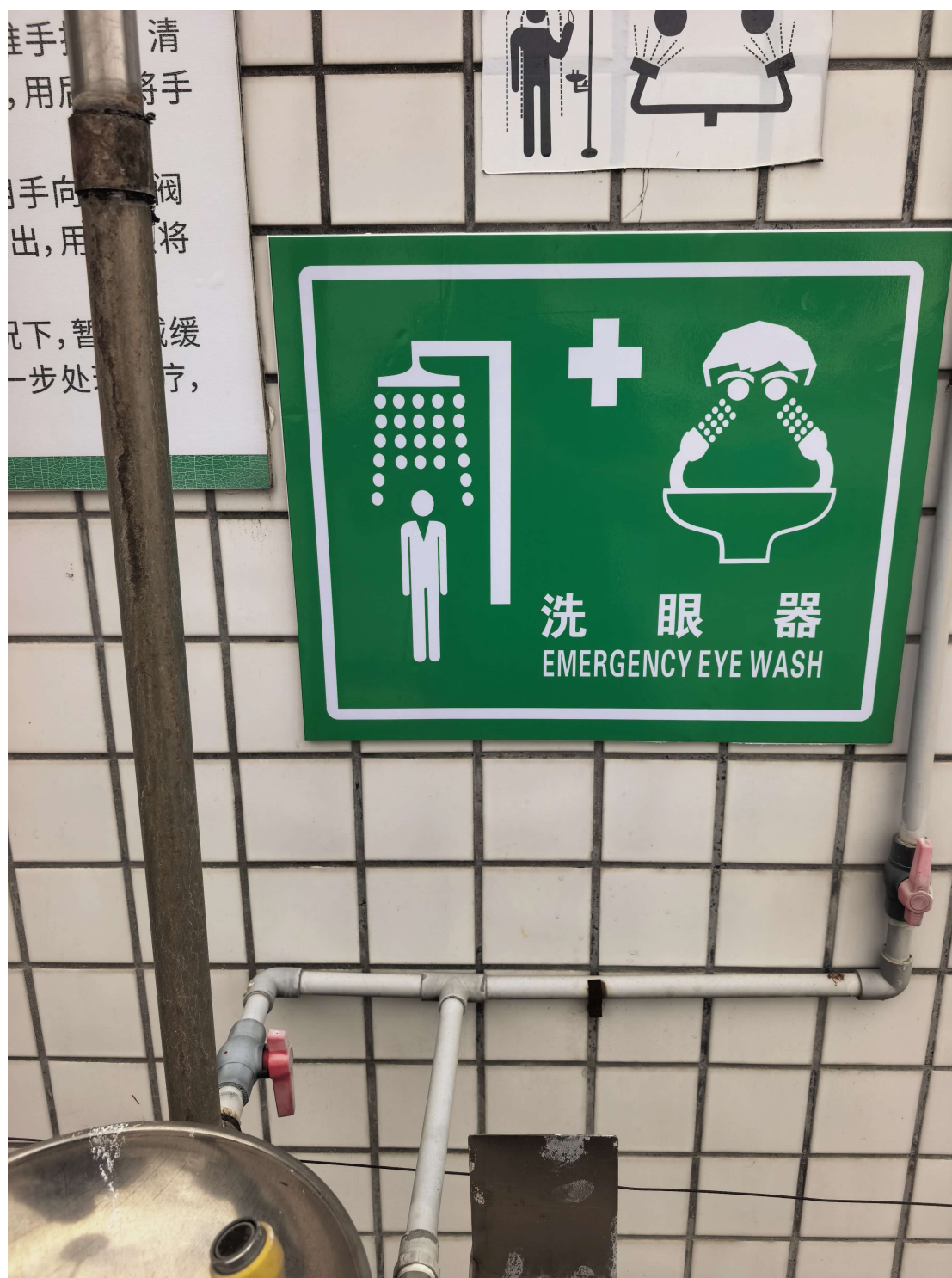
附图 3 安全喷淋洗眼器处均已设置安全标志牌
