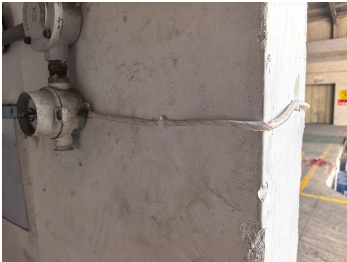
附图 2 有毒和可燃气体探测器、防爆开关均已进行防静电接地
