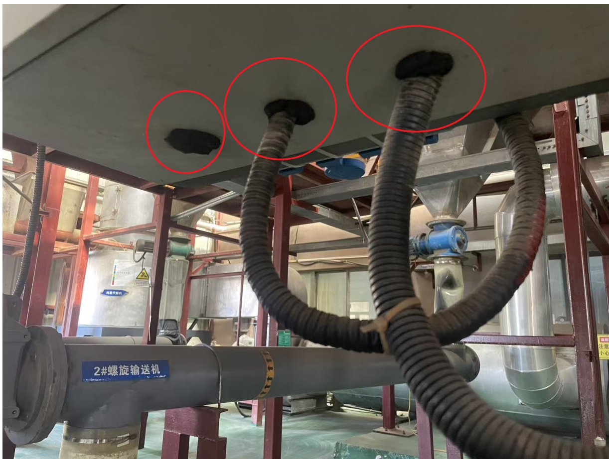
附图 7.3.5-1 再利用火法车间配电箱底部孔洞已封堵
