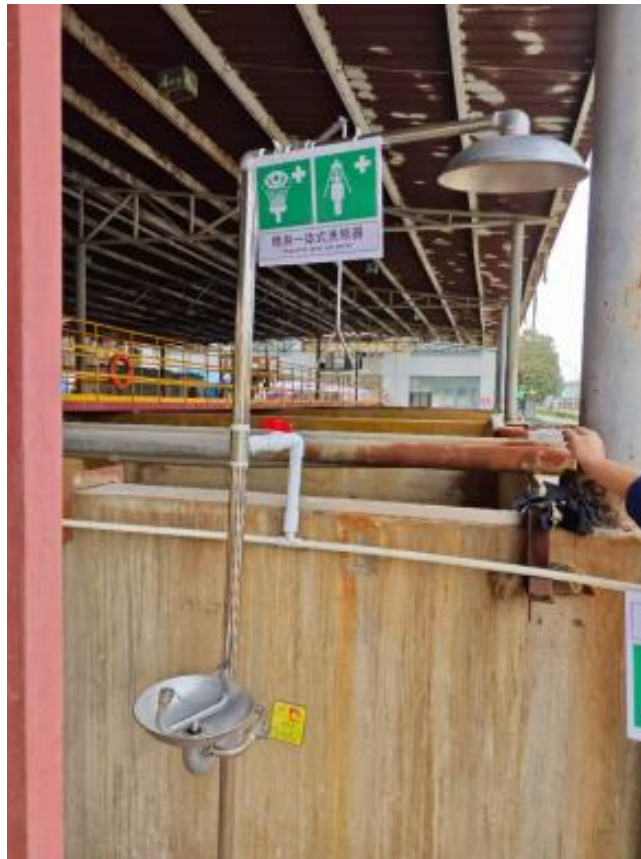
附图 3 污水处理场地-硫酸铝溶液储池旁边已设置淋洗器、洗眼器等卫生防护设施
