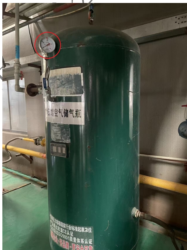
附图 7.3.5-2 再利用火法车间有储气罐压力表已标注压力红线
