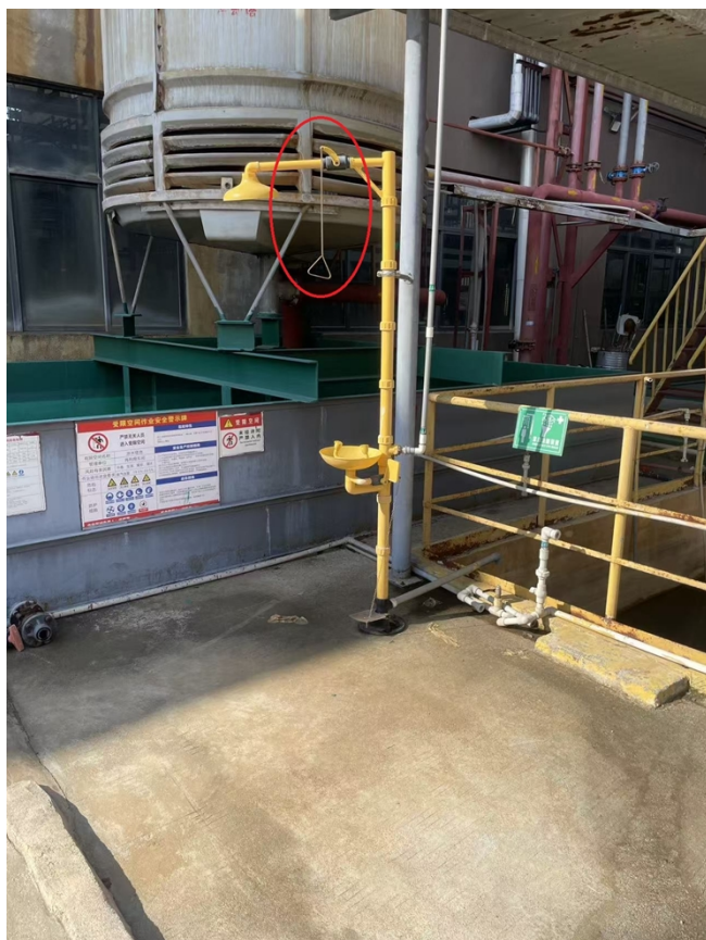
附图 7.3.5-3 再利用火法车间洗眼器的拉杆已调整安装方向
